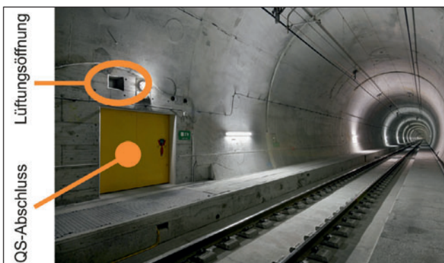
5 Rechteckige Lüftungsöffnung oberhalb des Querschlagabschlusses
