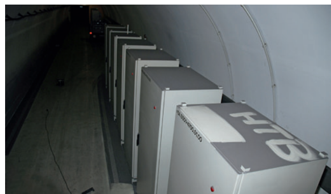
6 Äußere Verschmutzung der staubdichten Schaltschränke
